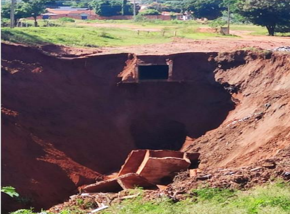
Macrodrenagem em processo de destruição.
